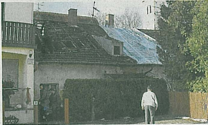
Ausgebrannte Ruine. Das Haus ist abbruchreif.
